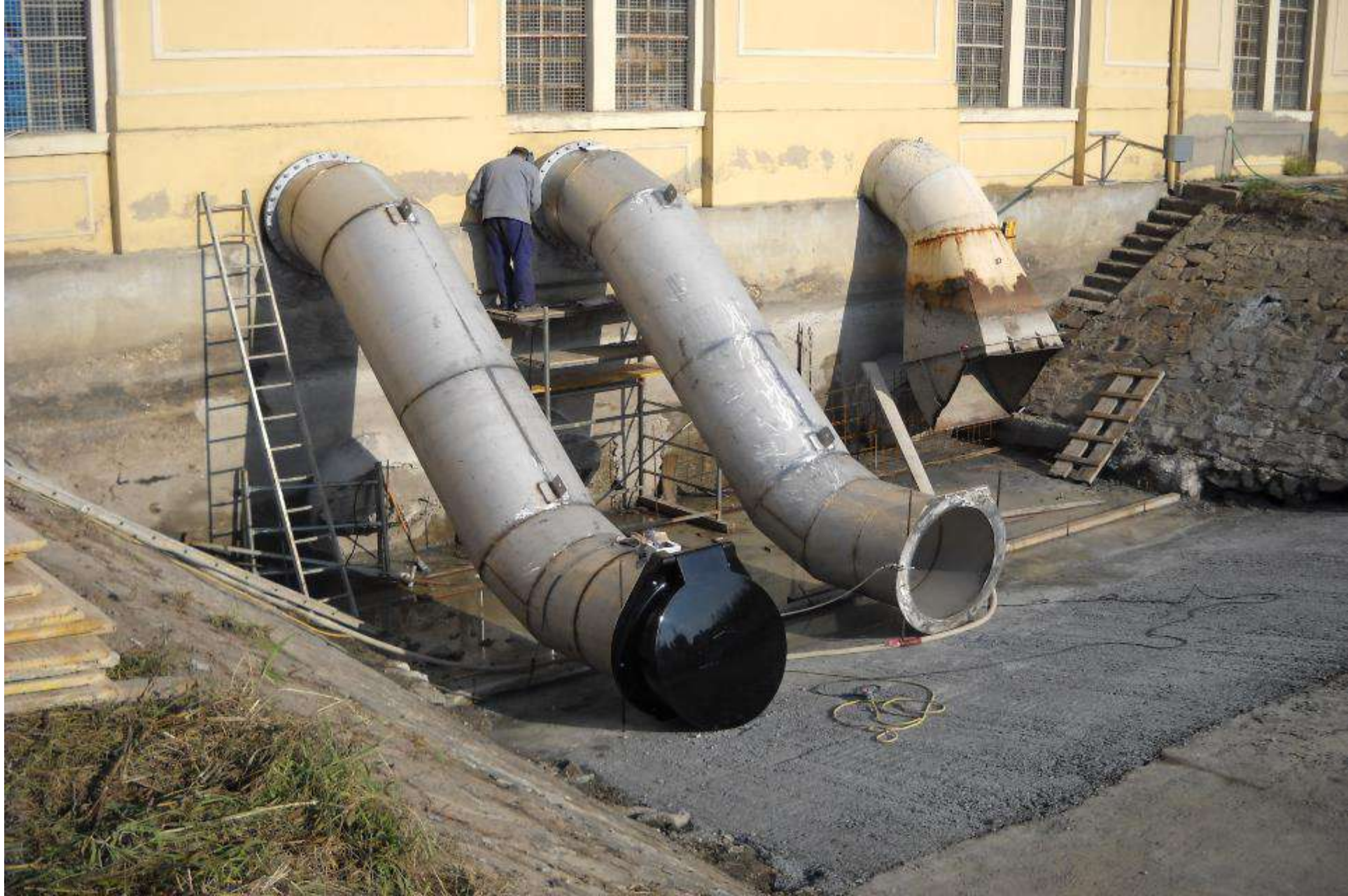
MANUTENZIONE IMPIANTO IDROVORO
