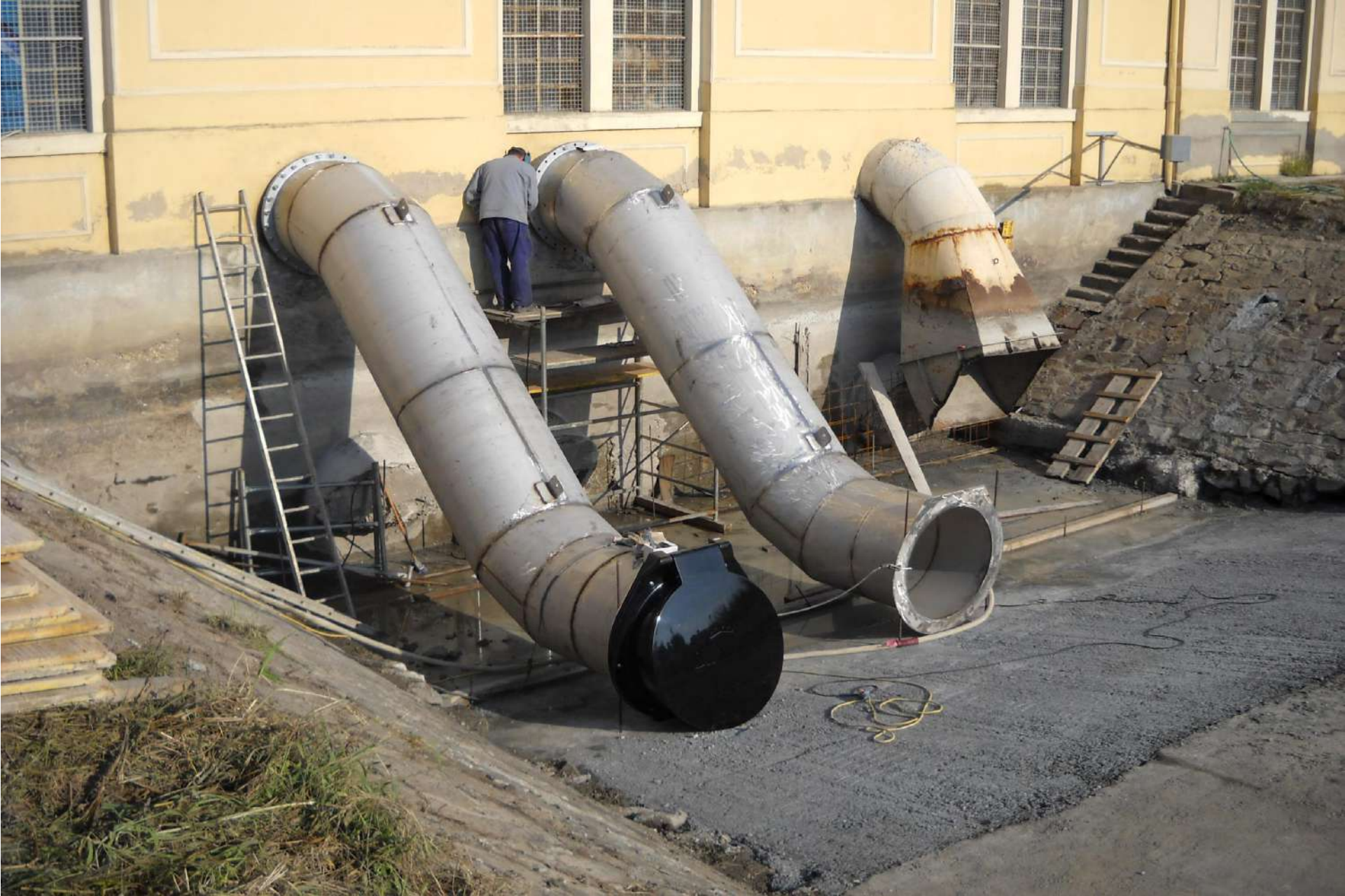
MANUTENZIONE IMPIANTO IDROVORO
