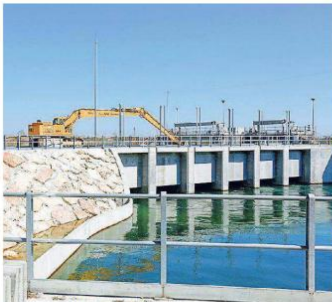
La nuova centrale idroelettrica di Nervesa
