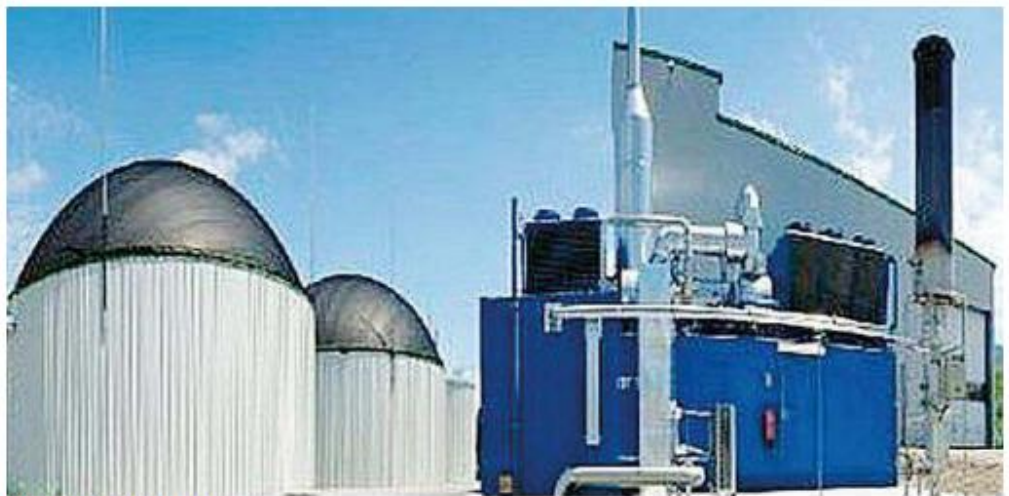
Un impianto a biomasse
