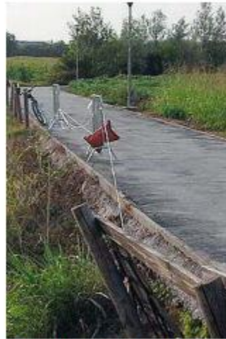
Il tratto di protezione crollato
