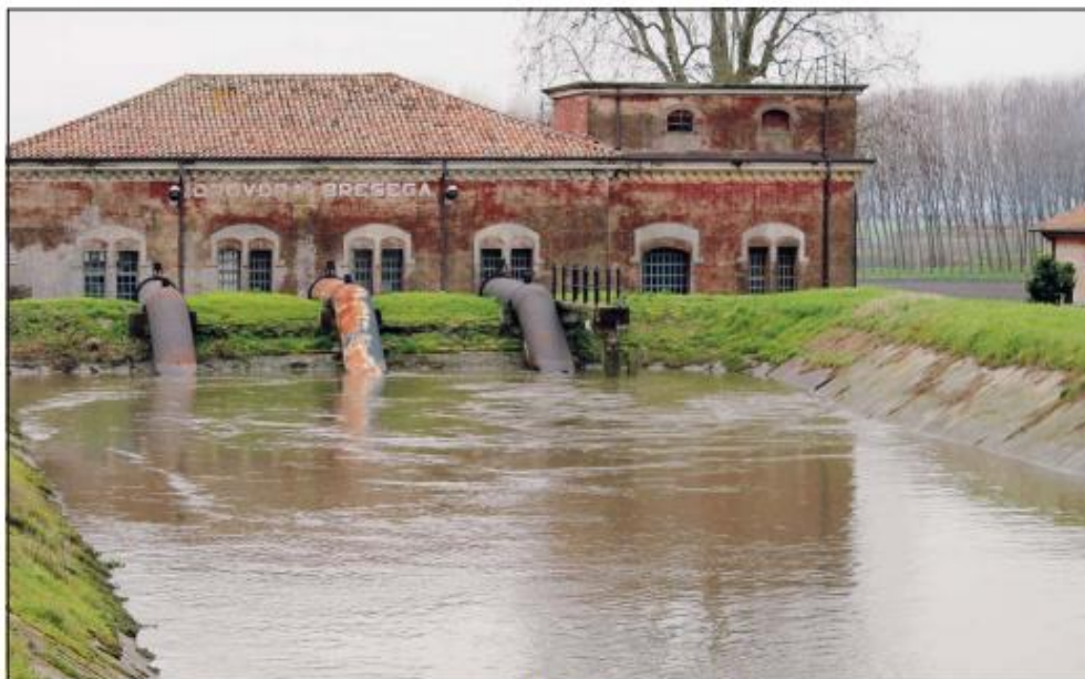
Uno dei sistemi che in Polesine controllano il livello di canali e fiumi
