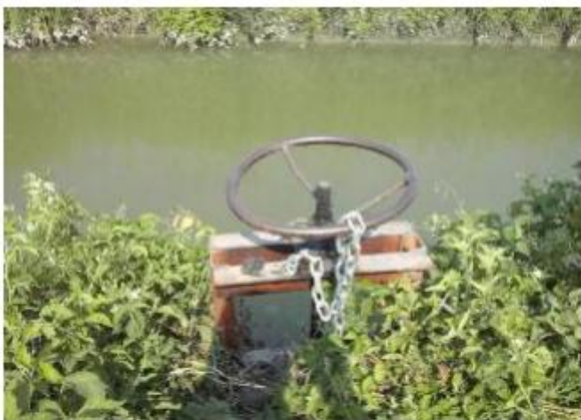
Una delle paratie forzate dai «ladri d'acqua»
