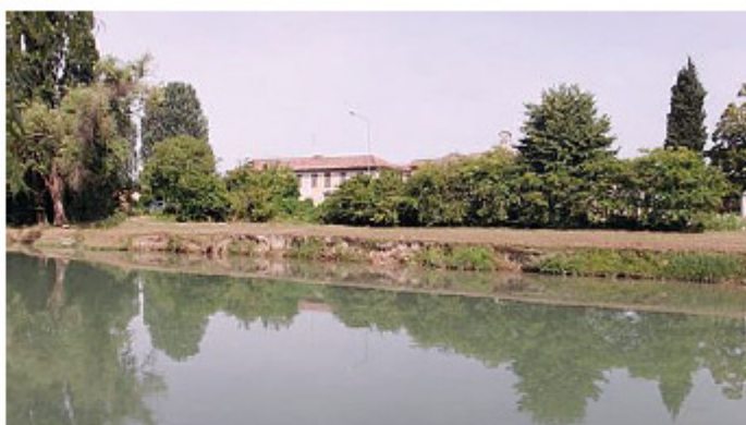
L'argine crollato sul Naviglio Brenta
